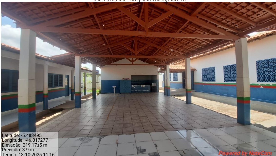
IMAGEM 13- PISO DO PATIO QUE SERÁ TOTALMENTE TROCADO JUNTO COM CONTRA PISO, E CANTINA QUE RECEBERÁ PORTÃO DE ENROLAR E PORTA DE FERRO.
