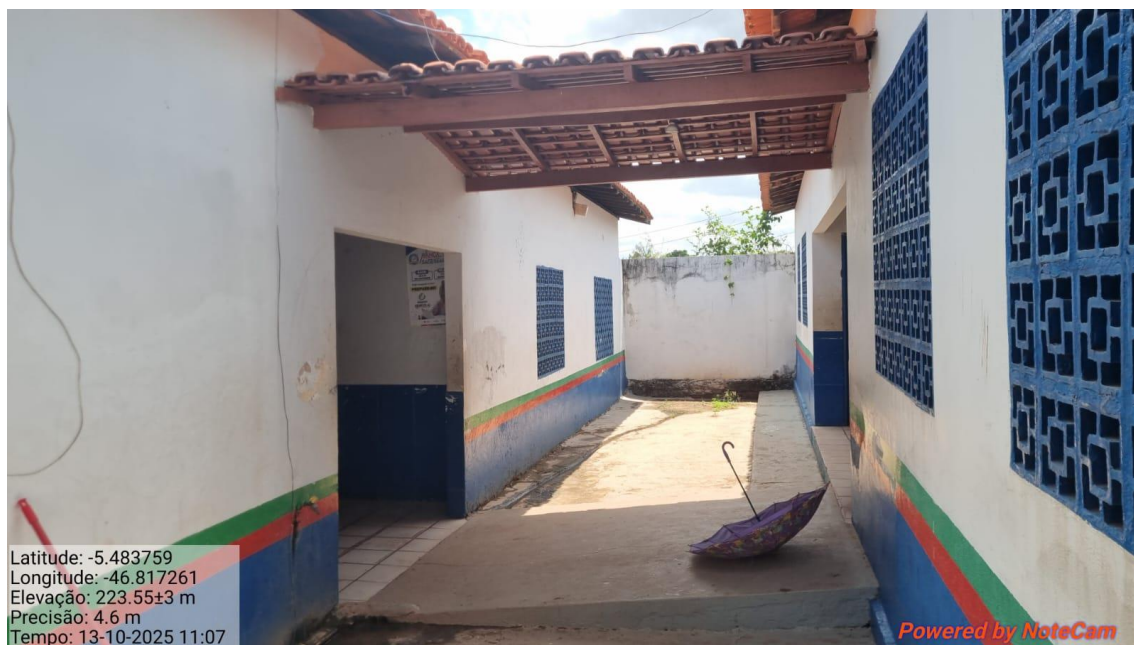
IMAGEM 26 - COBOGÓS DE SALA DE ALUA QUE SERÃO TROCADOS POR JANELA DE ALUMÍNIO E VIDRO E CALÇADAS REFORMADAS.
