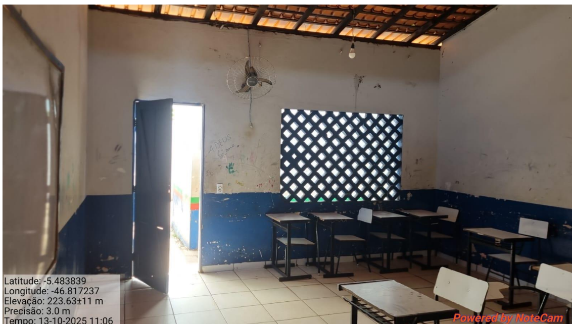
IMAGEM 18 - SALA DE AULA COM COBOGÓ QUE SERÁ TROCADOS POR JANELA DE VIDRO E ALUMÍNIO, PISO TROCADO, RESVESTIMENTO DE PAREDE NOVOS E FORRO.
