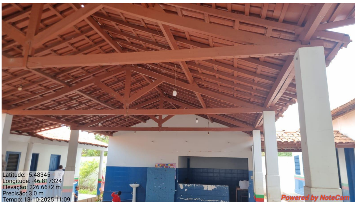
IMAGEM 2- TRELIÇAS DE MADEIRA DO PÁTIO E FACHADA FRONTAL DA CANTINA NO BLOCO 2 ONDE SERÁ COLOCADO PORTÃO DE ENROLA E REFORMADO.
