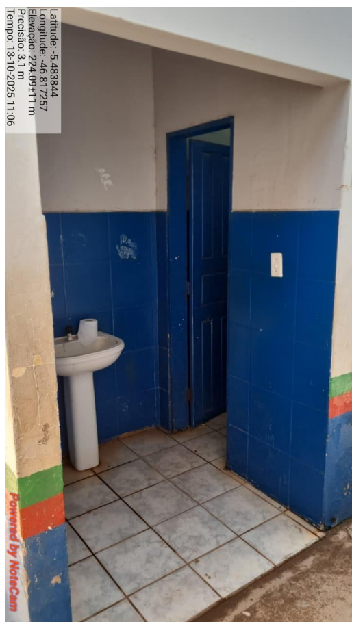
IMAGEM 21 – BANHEIRO QUE SERÁ RECONSTRUIDO
