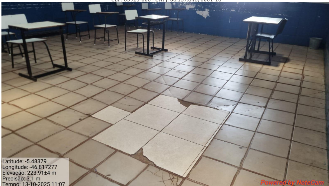
IMAGEM 20 - PISO DANIFICADO DEVIDO AO RECALQUE NO SOLO NO BLOCO 1 QUE SERÁ FEITO A TROCA DO MESMO , TROCAS DOS COBOGÓS POR JANELA DE VIDRO E ALUMÍNIO E FORRO DE GESSO.
