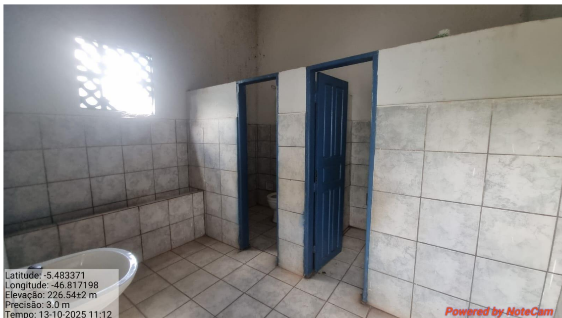
IMAGEM 11- BANHEIRO MASCULINO NO BLOCO 2 QUE SERÁ TOTALMENTE REFEORMADO
