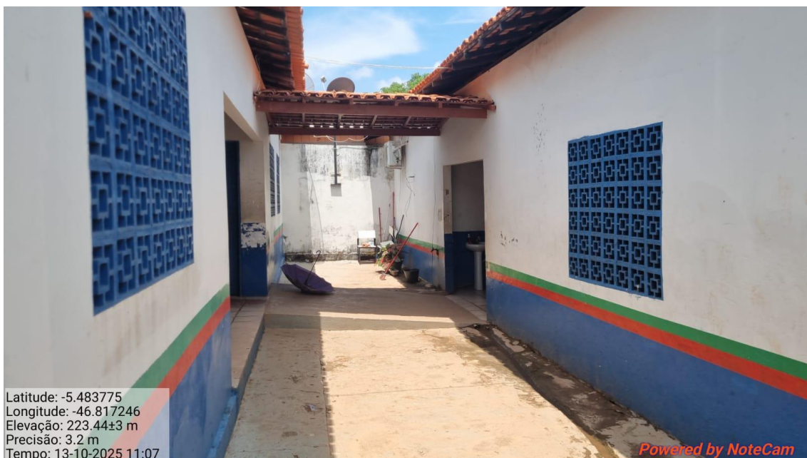
IMAGEM 23 – COBOGÓS DE SALA DE ALUA QUE SERÃO TROCADOS POR JANELA DE ALUMÍNIO E VIDRO E CALÇADAS REFORMADAS.
