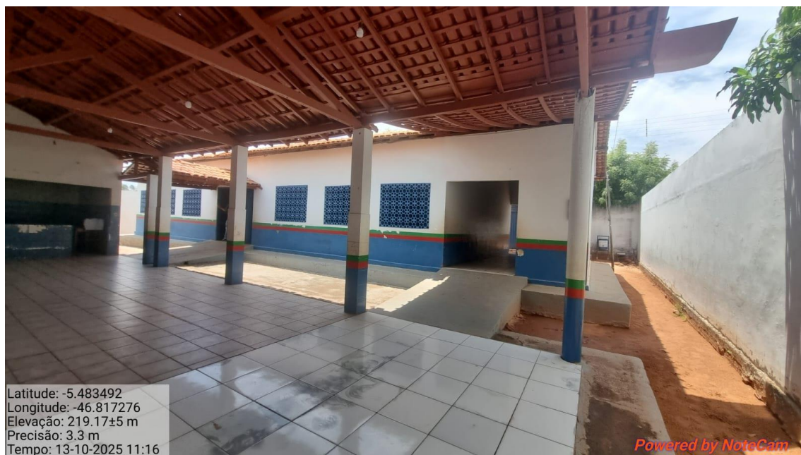
IMAGEM 12- PISO DO PÁTIO QUE SERÁ QUE TROCADO, COBOGÓS DAS SALAS DE AULA QUE SERÃO TROCADOS POR JANELAS DE ALUMÍNIO E VIDRO.
