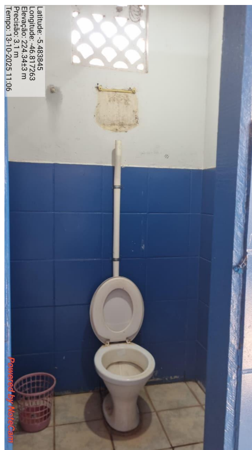
IMAGEM 22 – BANHEIRO QUE SERÁ RECONSTRUIDO
