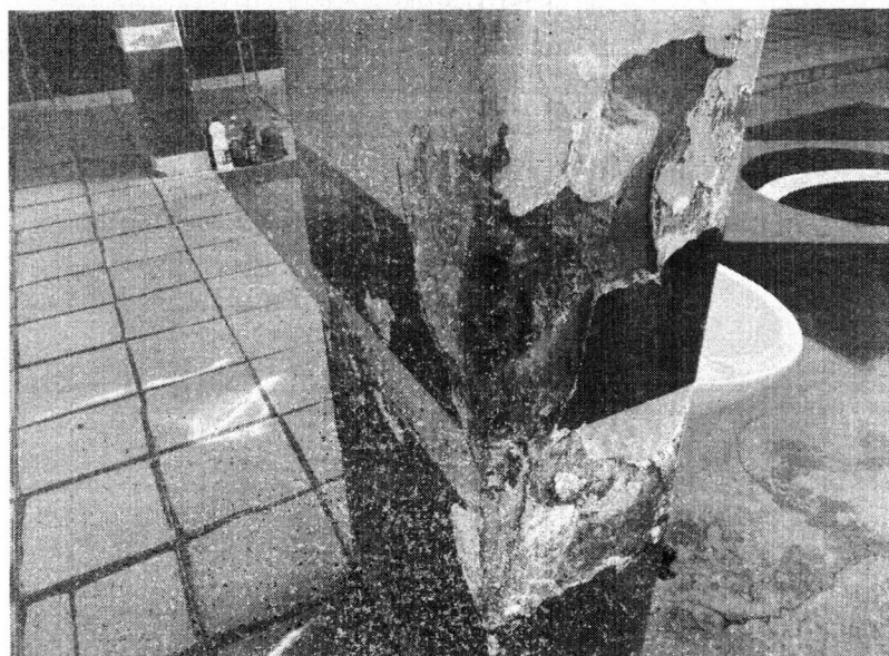
Patologias encontradas na edificação com necessidade de recuperação
