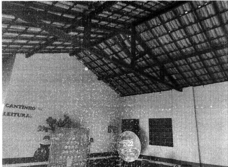
Detalhe da cobertura que necessita de reparos
