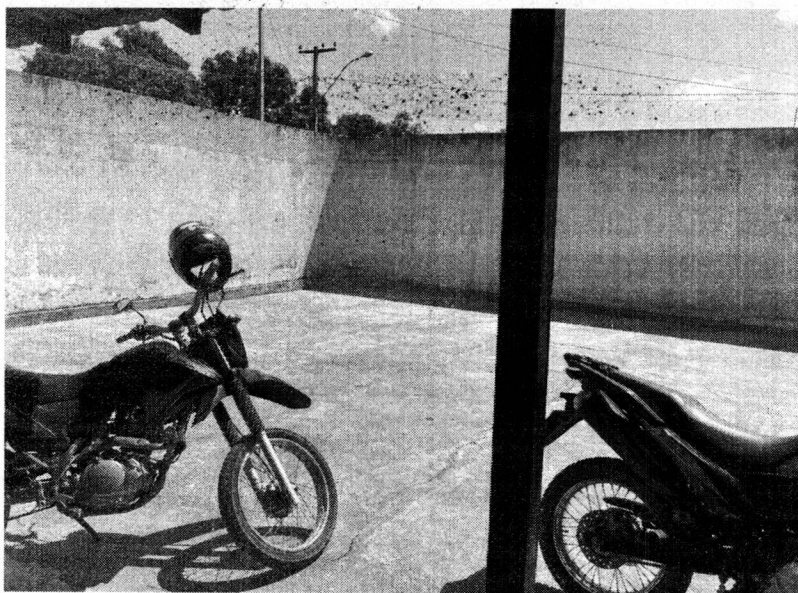
Calçada frontal da escola com necessidade de reparos
