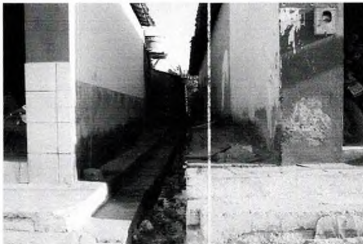
Fig. 15 Esgoto a céu aberto
